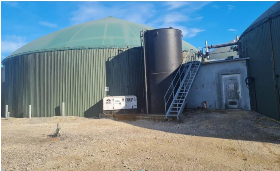
Visite d'un méthaniseur : production de gaz vert
